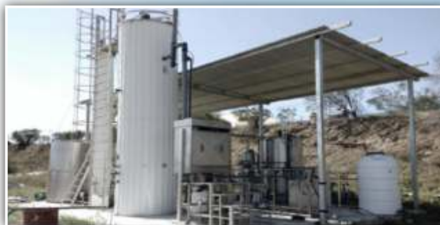
Πιλοτική μονάδα αναερόβιας χώνευσης
